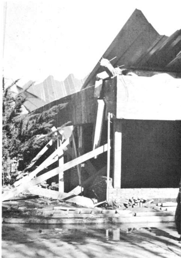
El derrumbe del gimnasio constituyó un desafío para los dirigentes del club. Doloroso impacto.
